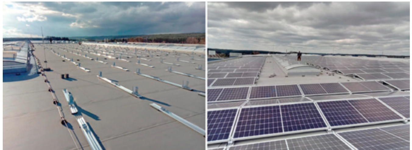
IL TETTO PIANO HA UN IMPIANTO FOTOVOLTAICO CON UN TOTALE DI 1.168 MODULI SOLARI E UNA POTENZA DI 367,92 KWP. IL SISTEMA DI MONTAGGIO ADATTO È LA D-DOME V
