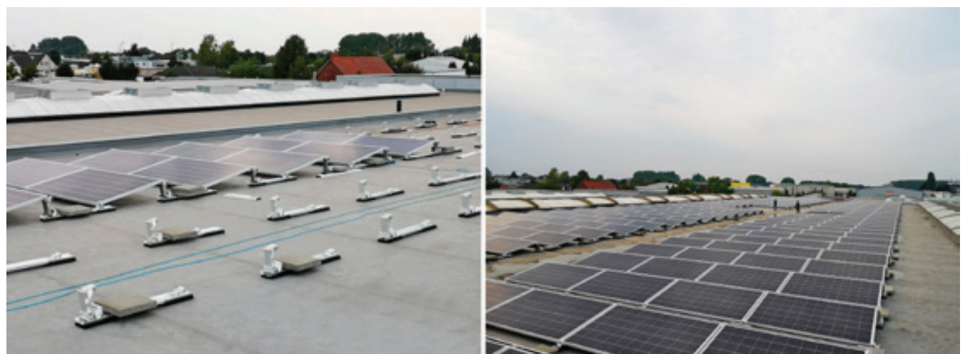
IL TETTO PIANO HA UN IMPIANTO FOTOVOLTAICO CON UN TOTALE DI 724 MODULI E UNA POTENZA DI 199,10 KWP. IL SISTEMA DI MONTAGGIO ADATTO È LA S-DOME V 10°
